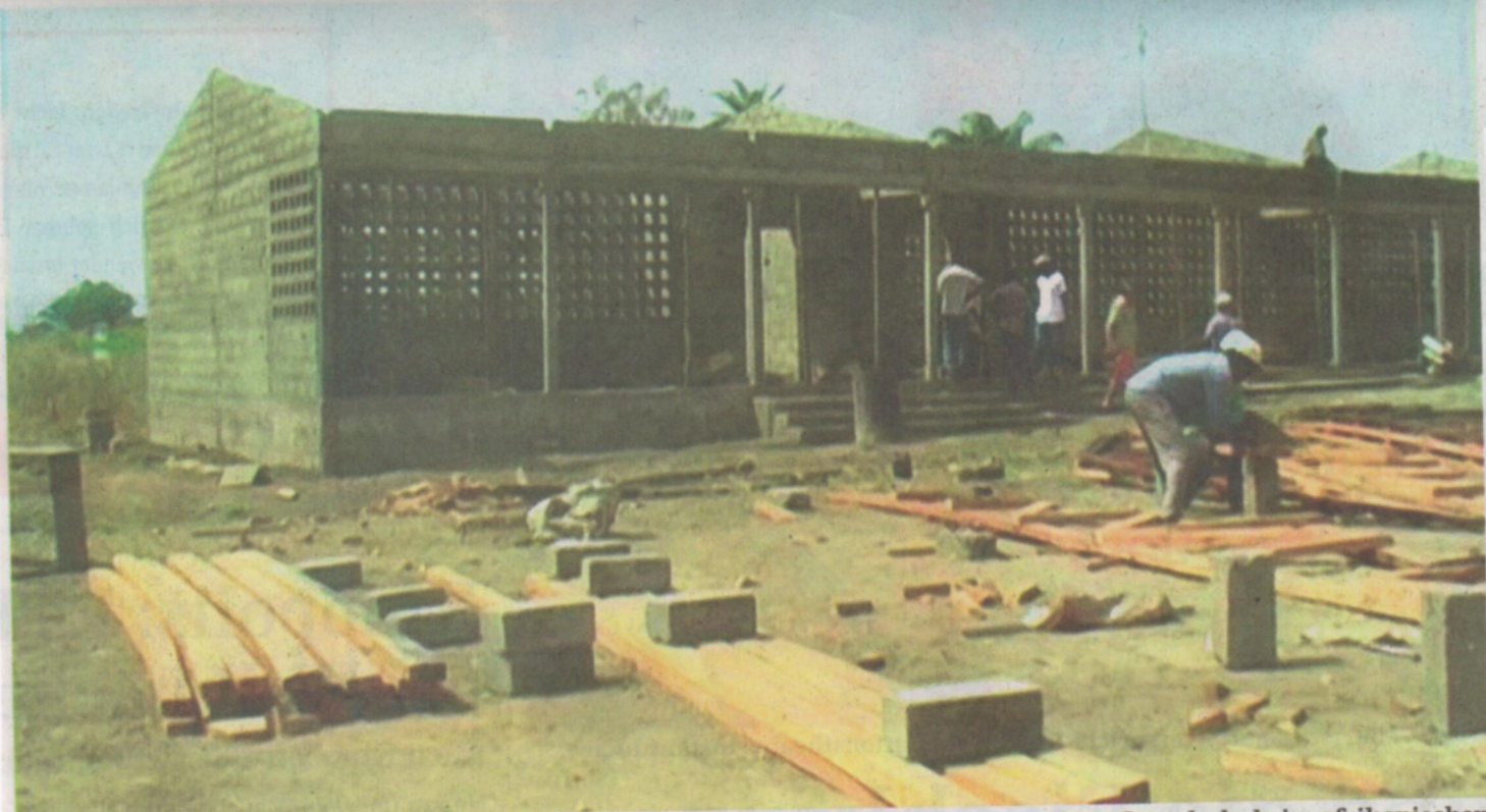
Der Film „Nur ein Sandkorn“ dokumentiert die Entstehung eines Erweiterungsbaus einer Grundschule im afrikanischen Togo. Das Projekt wurde vom Verein „Brigitte Lobin für Kinder in Afrika“ finanziert. Fotos: Privat
